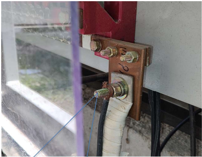
Conexión de Tablero distribución zonas comunes de la torre 5 en armario de medidores 1 de la misma torre, sin palabras, incumplimiento de la norma por todo lado.
