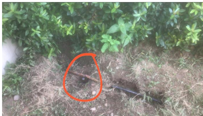
Registro fotográfico edificio de administración Conexión sistema pararrayos complejo áreas húmedas y administración Tomada el 17/11/2023
